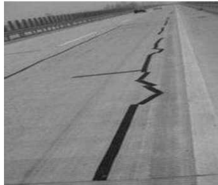
图 1 公路路面裂缝
