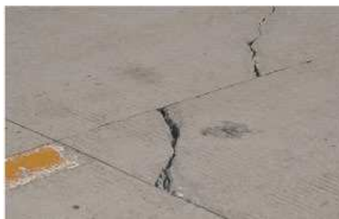
图2 角隅破坏现象
