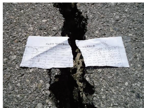
图1 公路路基沉降现象
