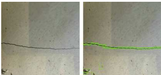
(a) 水平裂缝
