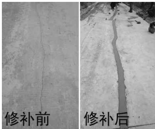
图1 公路裂缝修补前后对比图
