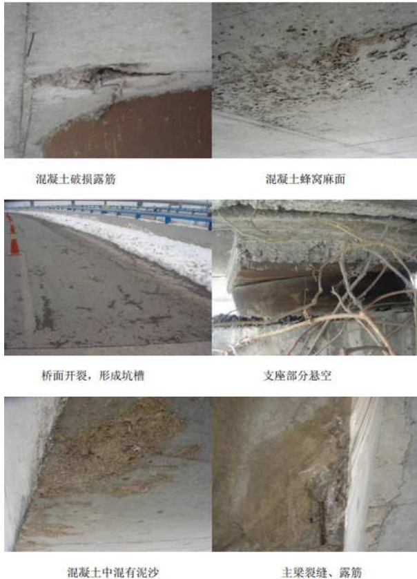
图2 常见桥梁病害
