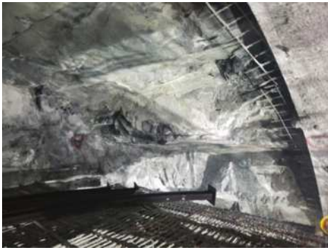
图1 拱顶水平岩层局部塌方
