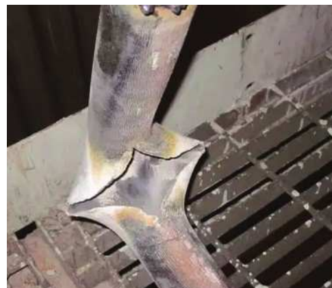
图1 锅炉过热器爆管
