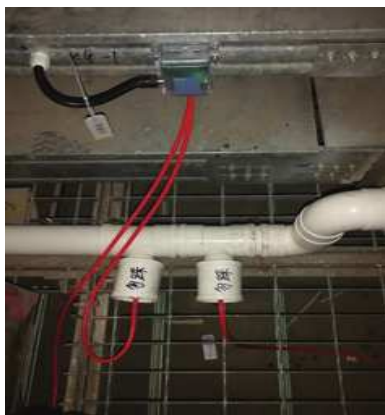
图3 压差监测实物图
