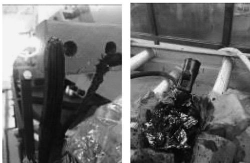
图 2 绕组出线压接部位损坏情况
