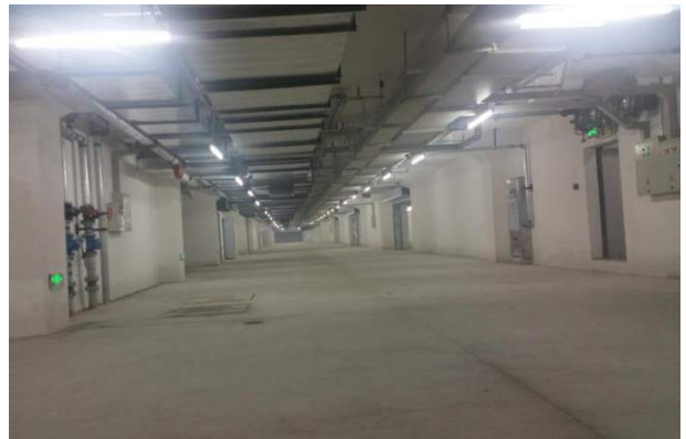
图二 地下人防建筑通风管道与控制设备
