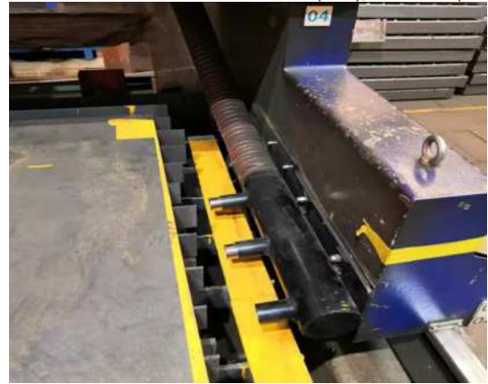
图 6 侧吹风风机出风口 3 个
