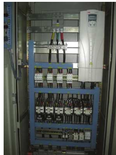
给排水 PLC 设备
