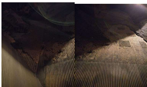
图 5 炉膛内运行情况
