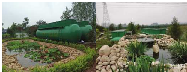
草堂营村污水处理站
