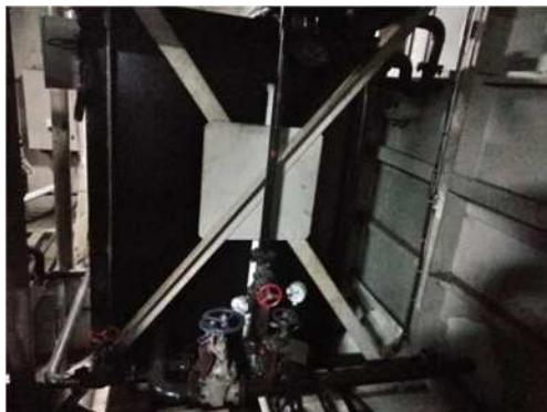
图3 生活污水接收箱（一次系统）
