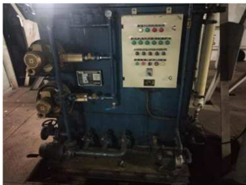
图4 生活污水处理箱（二次系统）
