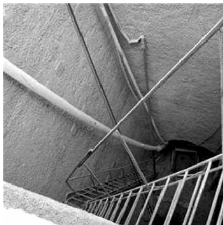
图1 高层电气竖井内的电缆敷设
