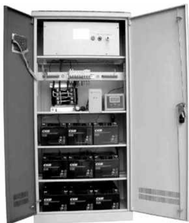
图2 高层建筑中的供配电设施
