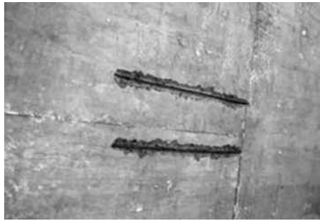
图2 房屋混凝土楼板露筋
