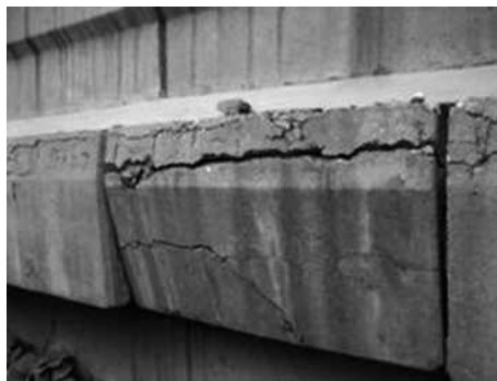
图1 房屋混凝土裂缝
