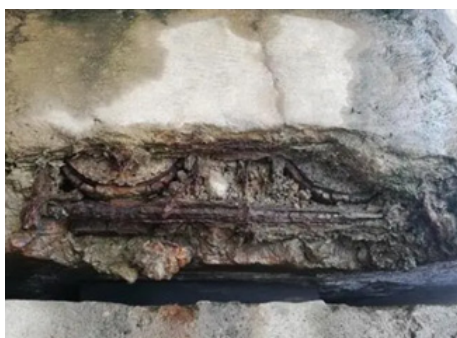
图2 桥梁板底部混凝土破损、钢筋锈蚀
