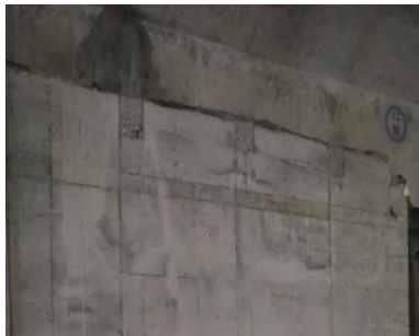
图5 未采用钢板止水带施工缝渗漏情况
