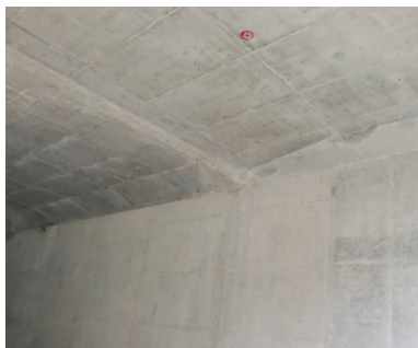
图6 采用钢板止水带无渗漏
