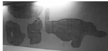
图三: 普遍存在墙体腻子层大面积剥落, 设计缺失挂网。
