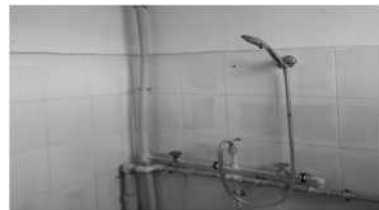
图二: 水管采用普通工装水管(热水管已变形), 设计缺失的热水管的包裹层。
