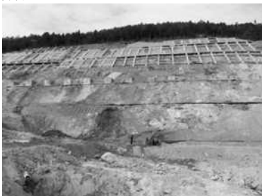
图 1 滑坡病害照片
