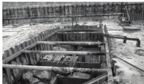
图1 深基坑塌方事故图
