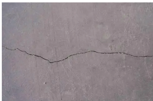
图1 混凝土浇筑裂缝
