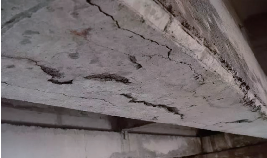
图2 桥梁钢筋混凝土结构出现的开裂现象
