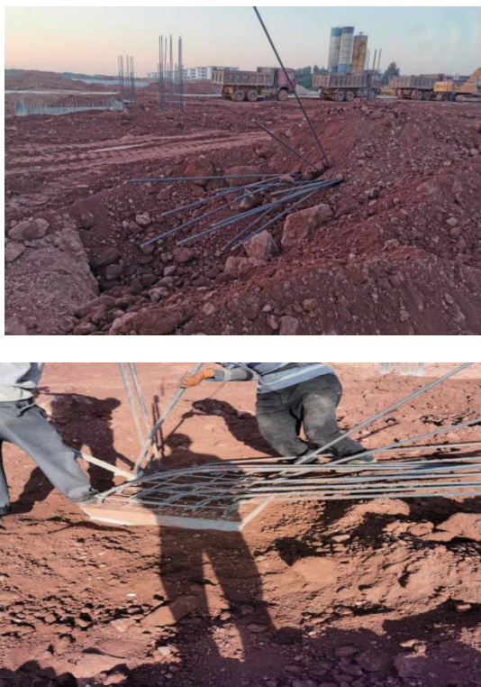
图2 柱头钢筋被压倒
