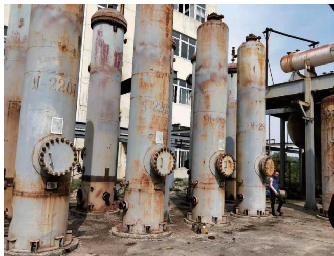
图1 化工装置设备腐蚀图示
