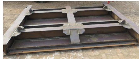
图1 一段时间后涂料剥落后的钢闸门
