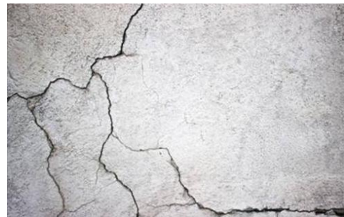
图 1 温度差异引起的裂缝
