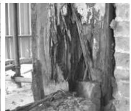
露明木构件内部蛀空
