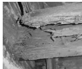
屋架端部腐蚀
