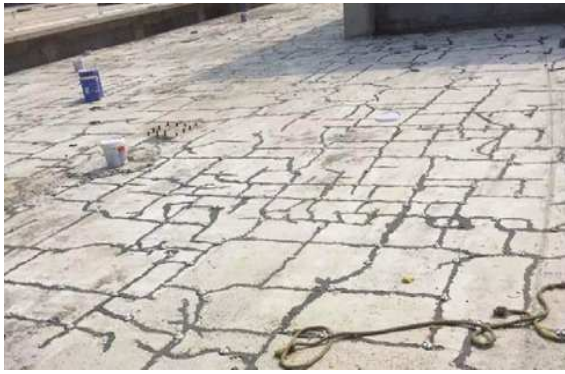
图2 收缩因素导致大体积混凝土产生裂缝
