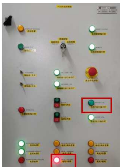
图 1 雷达 PCB 天线控制箱告警指示灯
