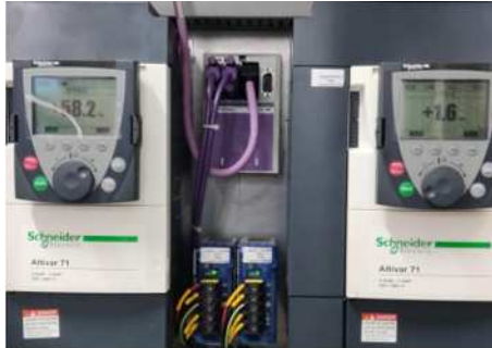
图 10 变频器恢复正常运行
