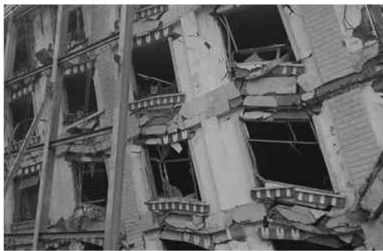
图2 地震中工程建筑损毁（来源网络）
