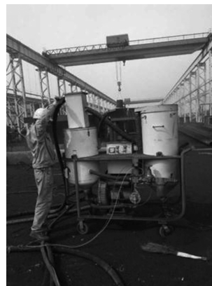
图2 油田管道除锈设备
