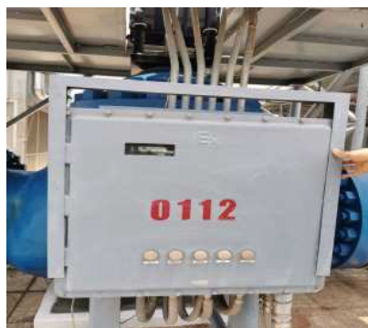
图6 调压阀控制箱防水设施
