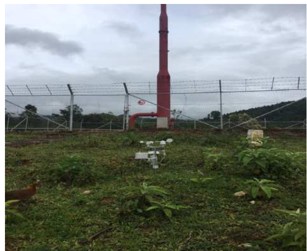
图 3 南坎站雨量监控系统
