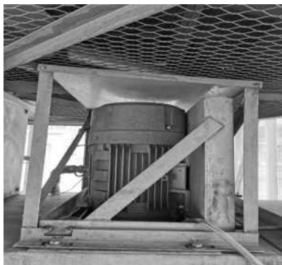
图4 CAT 发动机空冷器电机防水设施
