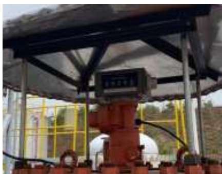
图5 流量计表头防水防晒设施
