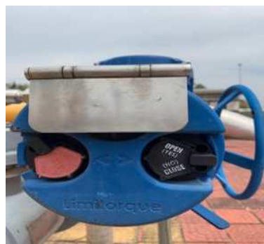
图7 阀门执行机构显示屏防晒设施
