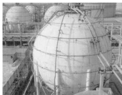
图1 安全喷淋设施
