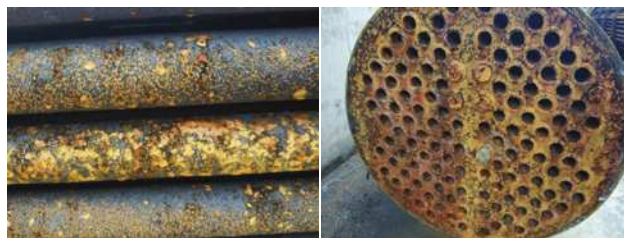
换热管外表面坑、点蚀形貌
