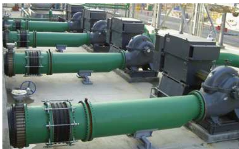
图5 某项目循环水泵入口照片
