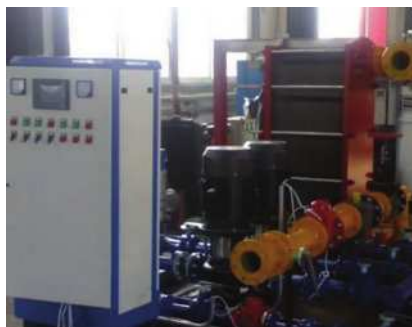
图1为化工供热系统中的变频控制设备
