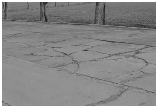
图 1 混凝土路面开裂图
