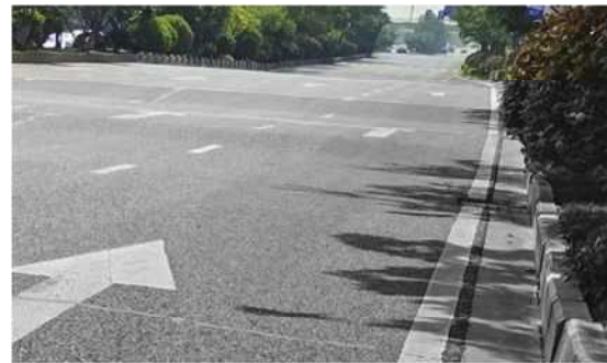
图1 不均匀沉降现场图
