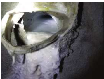
图1 隧道横向排水管水结晶体沉淀堵塞
