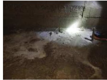
图2 隧道横向排水管水结晶体沉淀堵塞
