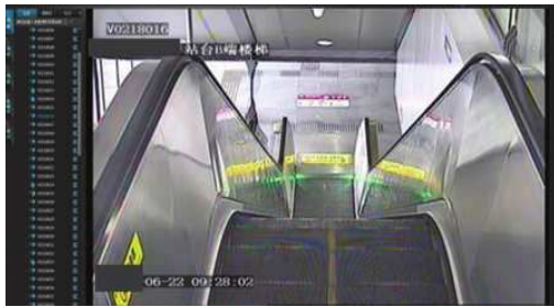
图8 常州地铁某站台B端扶梯监控的画面
