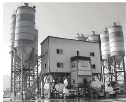
图1 水泥混凝土搅拌站
