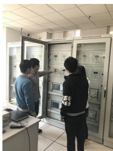
图5 天津大学硕士生在联合培养中心进行有源配电网馈线自动化测试
