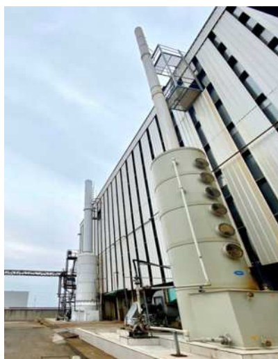
图 1 尾气高空排放塔
