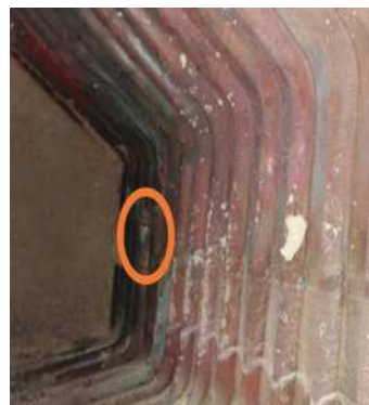
图3 锅炉水冷壁泄漏点
