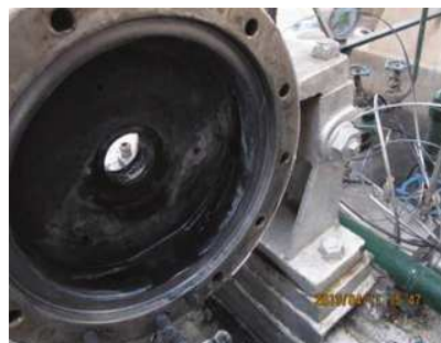
图4 泵体腐蚀情况
